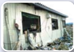
▲津波被害を受けた工場
