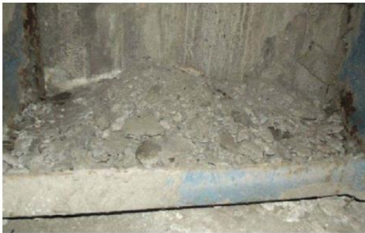
支承付近の土砂堆積
