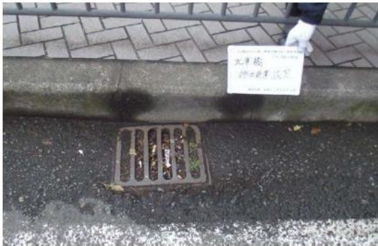
排水ますの土砂詰まり
