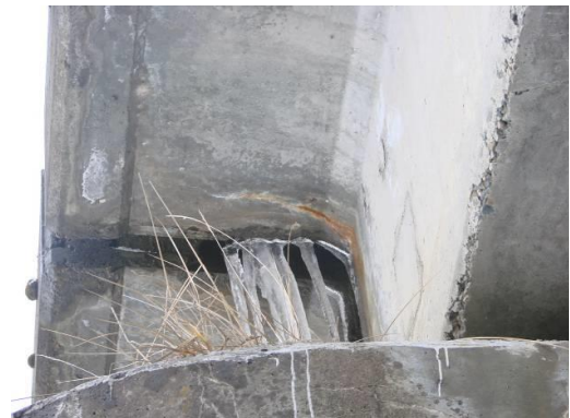
桁端部からの漏水
