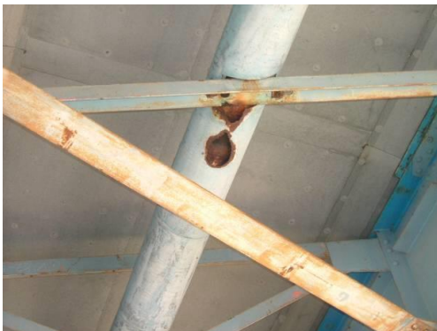
排水管の損傷
