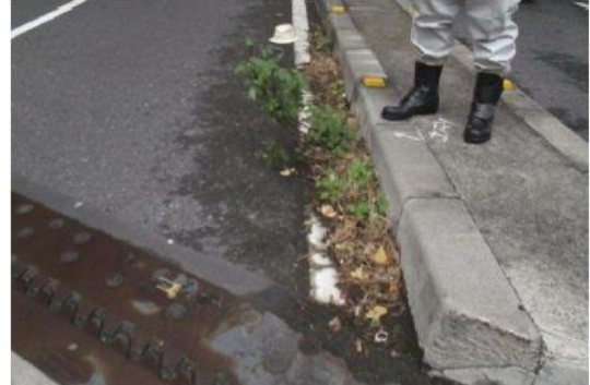
路面の土砂堆積
