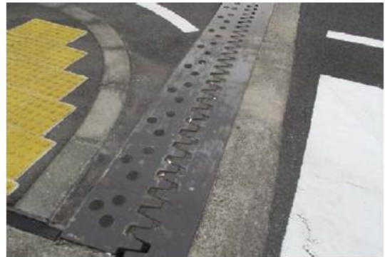
伸縮装置の土砂詰まり
