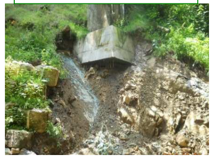
52k520m付近 羽根沢橋りょう洗掘
