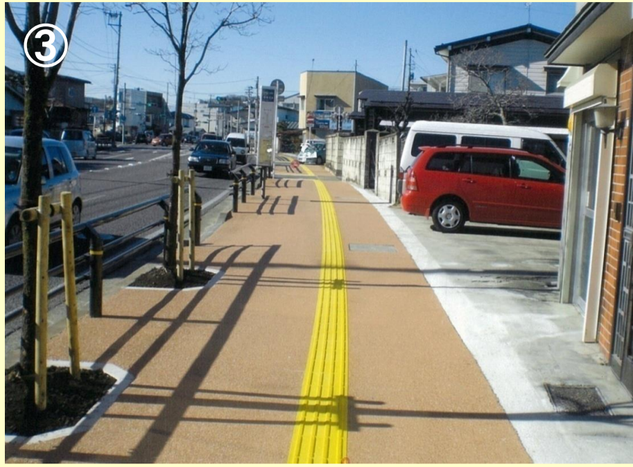
路線名：白河羽鳥線 事業名：やさしい道づくり推進事業 場所：白河市道場小路地内 工事説明：快適な歩行空間づくりを進めるため、歩道の段差解消および視覚障がい者用ブロックや透水性舗装の整備を進めています。
