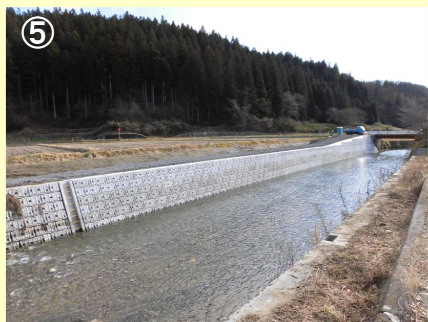
河川名：渡瀬川 事業名：河川海岸改良事業 場所：東白川郡鮫川村大字渡瀬地内 工事説明：村道や住宅の浸水被害を防止するため、河道拡幅や護岸工を整備しています。
