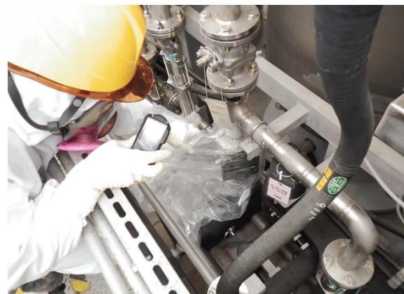
既設 ALPS 吸着塔の状況確認
