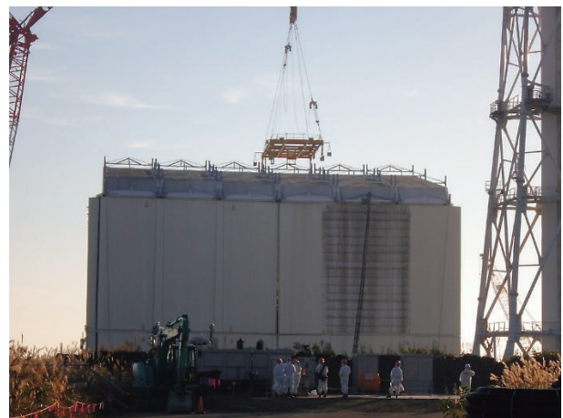
1号機カバー屋根パネル解体に立ち会う 廃炉安全監視協議会
