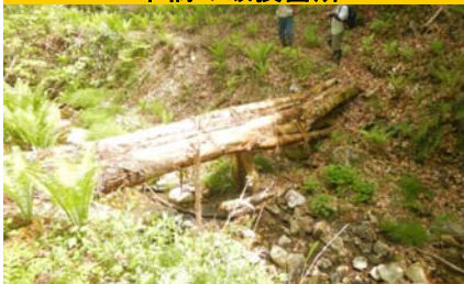
補修が必要な吉尾峠の木橋の破損箇所
