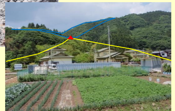
河川名：滝ノ沢 事業名：交付金事業 場所：東白川郡矢祭町大字関岡地内 工事説明：土石流による土砂災害を防止するため、砂防えん堤工の施工を進めています。
