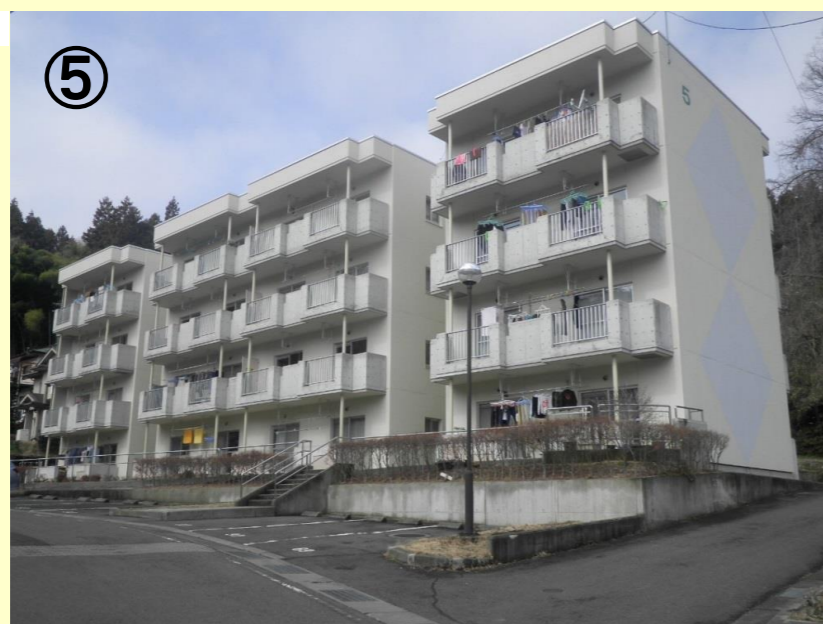
路線名：県営住宅関川窪団地 事業名：県営住宅改善工事(外壁・屋上防水改修) 場所：白河市関川窪地内 工事説明：外壁に断熱材を貼り付け外断熱化を行うとともに、屋上の防水性の向上を図り、より快適で安心な住環境を提供します。
