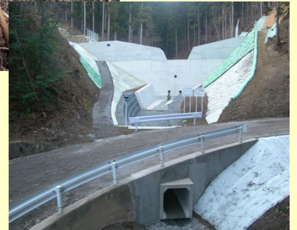
河川名：ボンケラノ沢 事業名：交付金事業 場所：東白川郡棚倉町大字大梅地内 工事説明：土石流による土砂災害を防止するため、砂防えん堤工の施工を進めています。
