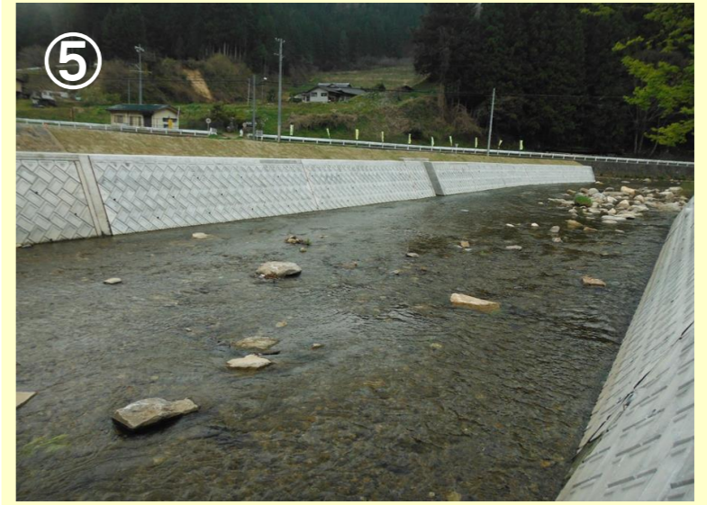
河川名：鮫川 事業名：河川海岸改良事業 場所：東白川郡鮫川村大字西山地内 工事説明：住宅や道路の浸水被害を防止するため、河道拡幅や護岸工を整備しました。
