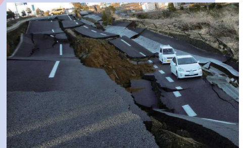
▲東日本大震災による道路崩壊（国道6号 広野町）
