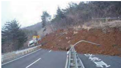
▲東日本大震災による土砂崩落状況（国道4号 福島市）
