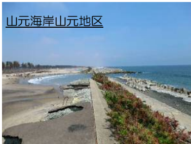
堤防の被災状況(山元町)
