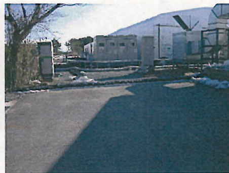
⑧蒸発濃縮装置付近
