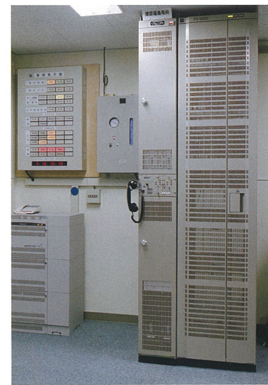
▲警報表示盤・多重無線装置
