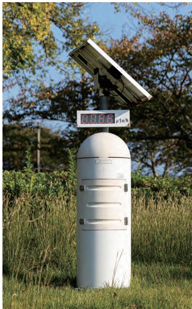
リアルタイム線量測定システム
