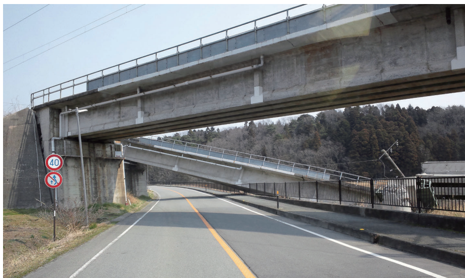
国道288号線 双葉町の常磐線陸橋の崩落(2011年3月30日撮影)
