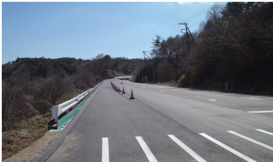
国道6号線 福島第二原発付近の道路崩落(2011年3月18日撮影)
