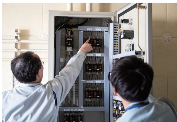
故障したブレーカー
