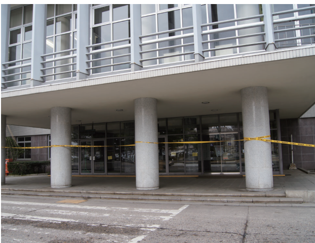
正庁は倒壊の危険性から立入禁止
