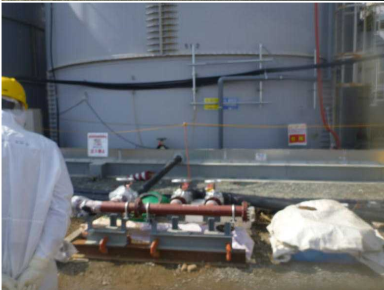
○ H6 タンクエリア 汚染土壌の未回収部分
