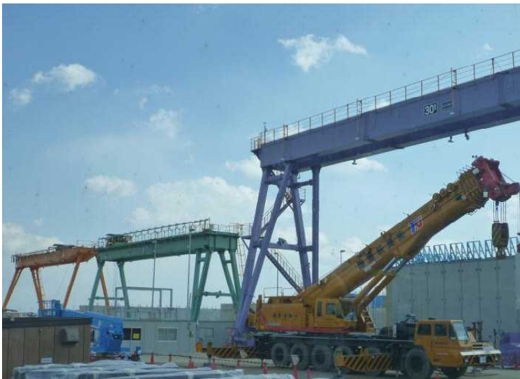
○使用済セシウム吸着塔 一時保管施設 (第一～第三施設)
