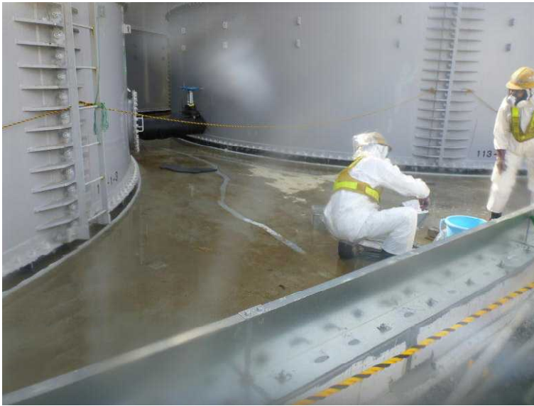
○ H5 タンクエリア コンクリートのひび割れ 箇所の塗装後の状態
