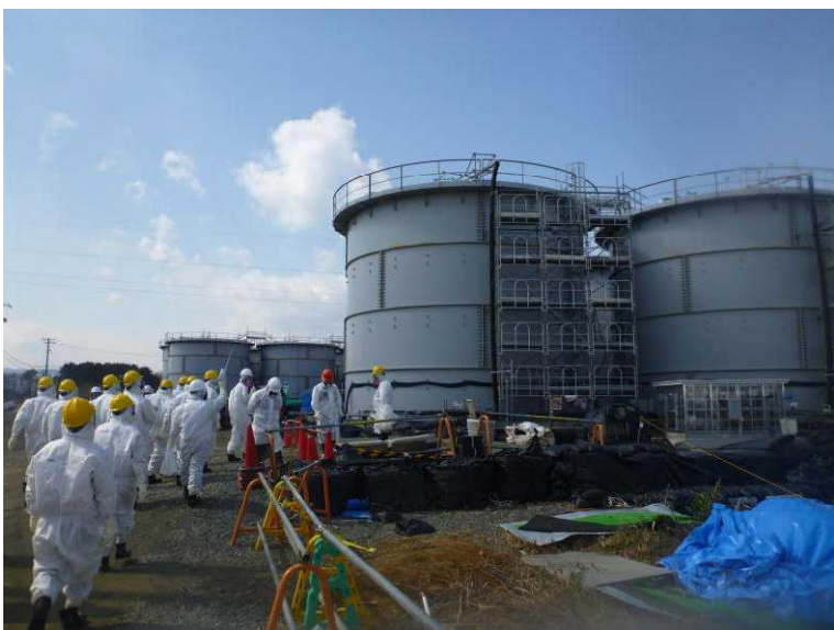
○H6 タンクエリア 汚染水漏えい箇所付近
