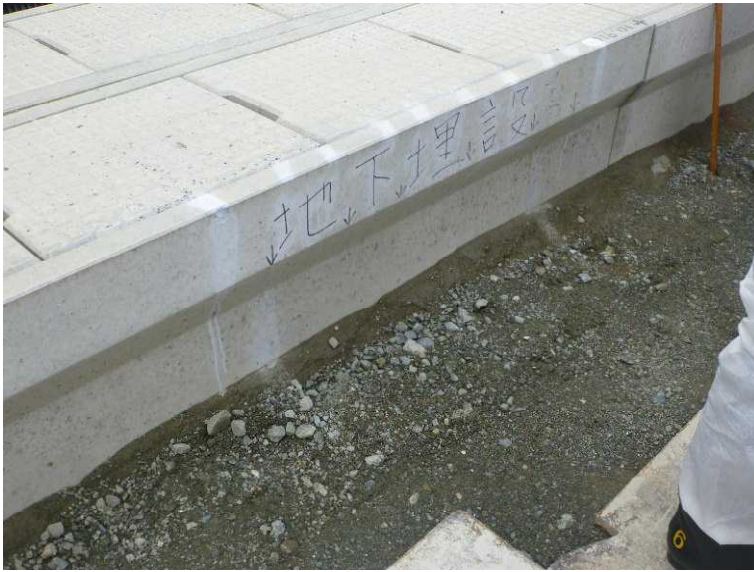
○地下埋設物があることを示す表示（ケーブル損傷後に応急的に表示している） （建屋止水対策工事現場）
