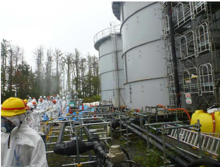
○H4タンク隣 移送配管 (汚染土壌の未除去箇所)
