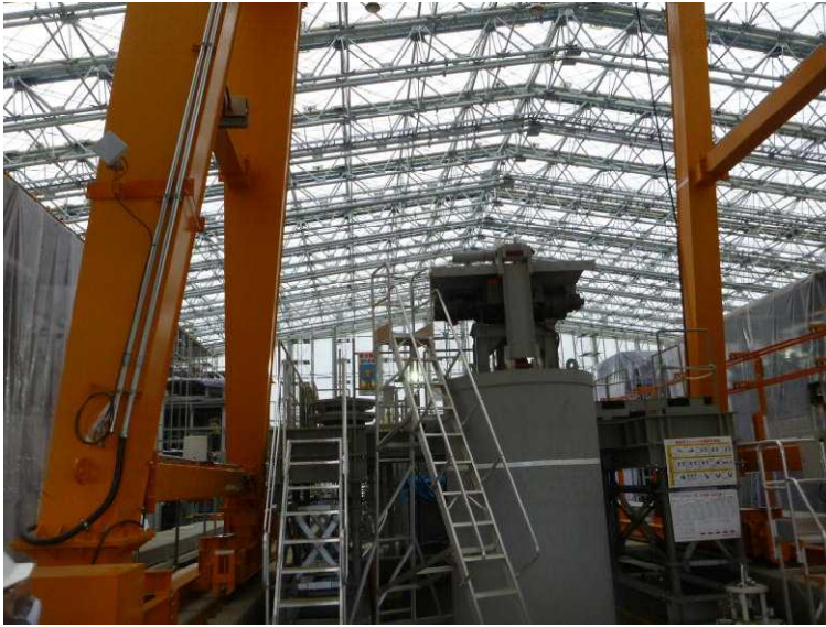
○H I C交換用クレーン (多核種除去施設(ALPS))
