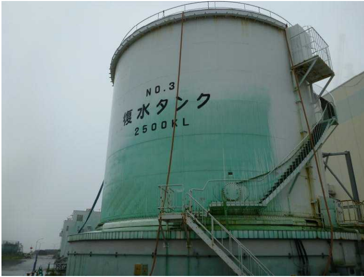
○3号機復水貯蔵（CST） タンク （3号機タービン建屋東）
