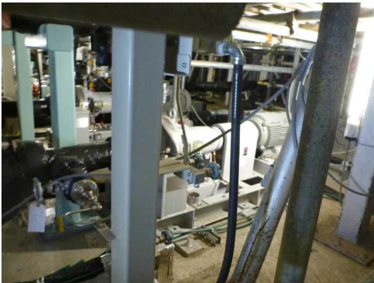
○原子炉注水ポンプ（2号機） （タービン建屋内）
