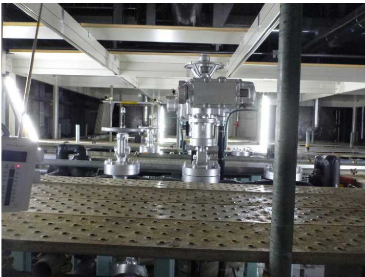
○炉注水ポンプ電動弁 （タービン建屋内） 免震重要棟から操作可能
