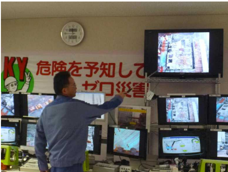
○ビデオカメラによる遠隔 監視 (遠隔操作室)
