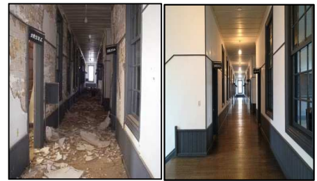
旧福島県尋常中学校本館の修復状況 (左が修復前、右が修復後)
