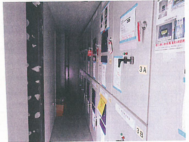
仮設3/4号M/C前面 (コンテナ内部)
