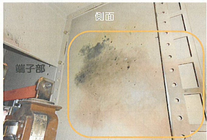
5Aユニット側面のアーク痕状況
