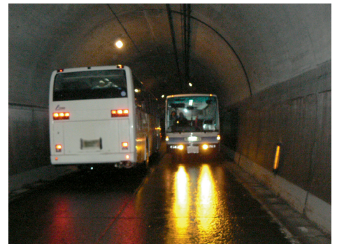
▲大型車すれ違い困難な状況（国道352号中山トンネル）
