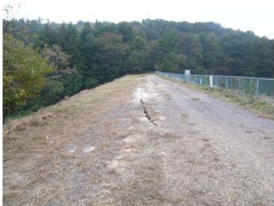
写真 2-70 被災状況 (平成 23 年 10 月 14 日撮影)
