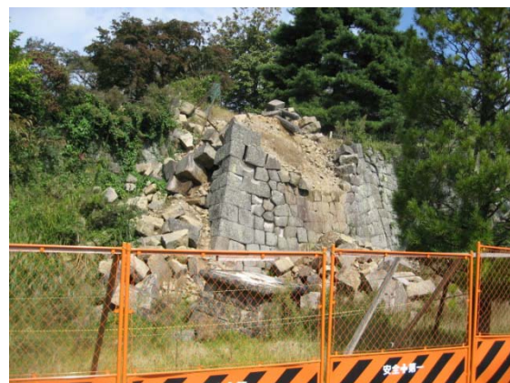
写真 1-2 小峰城の城壁被災状況 (平成 23 年 10 月 10 日撮影)
