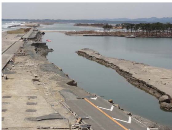
写真 2-23 海岸防災林の被災状況（相馬市） （平成 23 年 3 月 25 日撮影）
