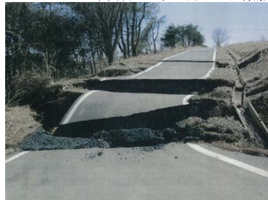
写真 2-12 農道の被災状況 (白河市 大信地区) (平成 23 年 3 月 18 日撮影)
