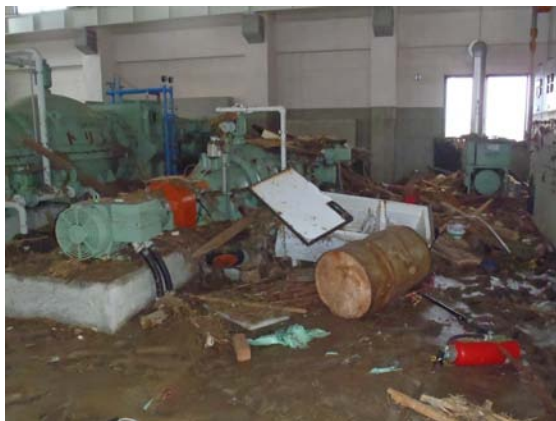
写真 2-49 被災直後 (平成 23 年 3 月 23 日撮影)
