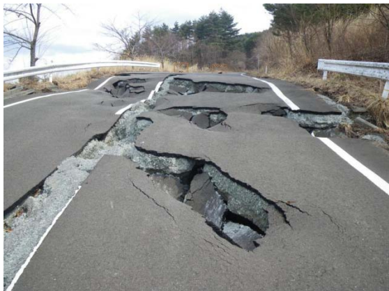
写真 2-17 地震により被災した林道花塚線 (平成 23 年 3 月 25 日撮影) (川俣町)
