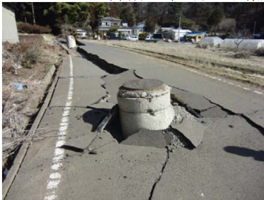
写真 2-11 地震により浮上した農業集落排水施設用マンホール (泉崎村 柁内地区) (平成 23 年 3 月 12 日撮影)
