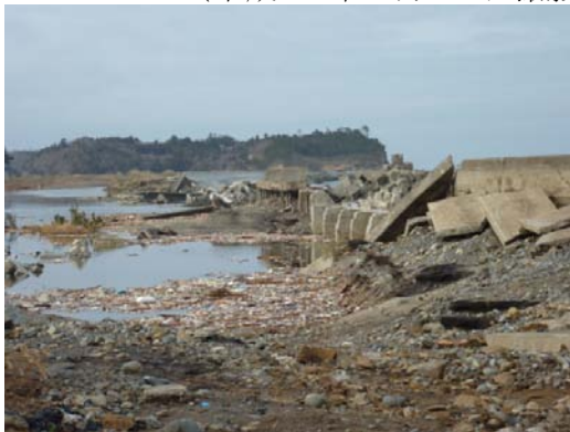
写真 2-13 津波により破堤した海岸堤防 (南相馬市 北海老海岸) (平成 23 年 3 月 25 日撮影)
