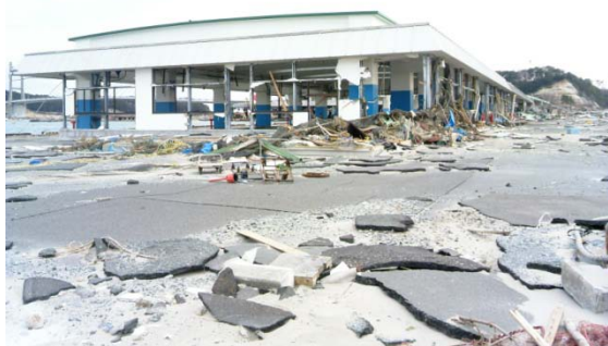
写真 2-53 相馬原釜地方卸売市場被災状況 （平成 23 年 4 月 18 日撮影）
