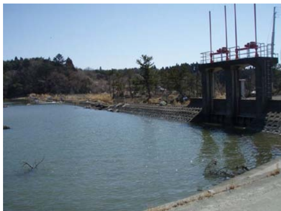
写真 2-43 被災状況 (平成 23 年 4 月 1 日撮影)
