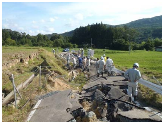
写真 2-57 災害査定状況（農道） （平成23年8月29日撮影）（いわき市）
