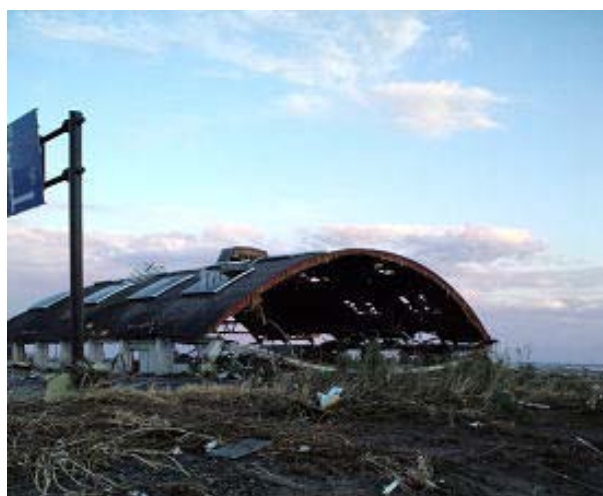
写真 1-5 津波の被害を受けた 県ヒラメ栽培漁業振興施設（稚魚棟） (平成 23 年 3 月 11 日撮影)
