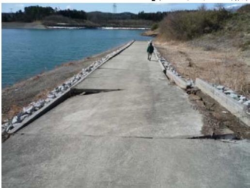
写真 2-63 被災状況 (平成 23 年 3 月 12 日撮影)
