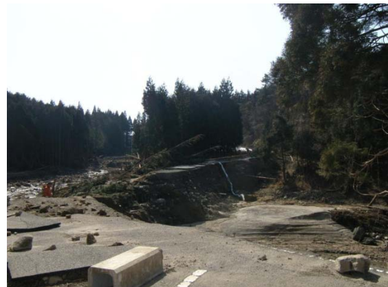
写真 2-18 地震により被災した林道戸渡藤沼線 (平成 23 年 3 月 25 日撮影) (須賀川市)
