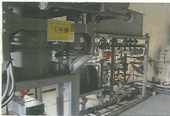
放水口モニタ (現在仮設で運用中)
