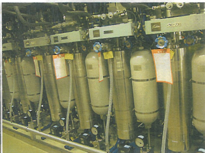
1号機水圧制御ユニット
