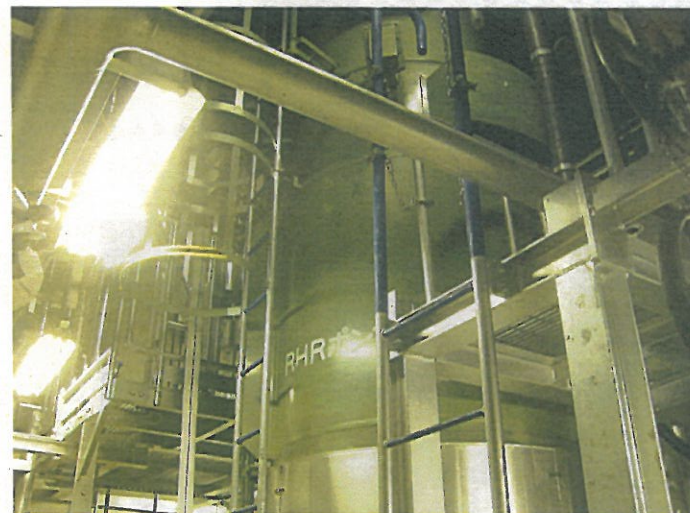
1号機残留熱除去系(RHR)ポンプ
