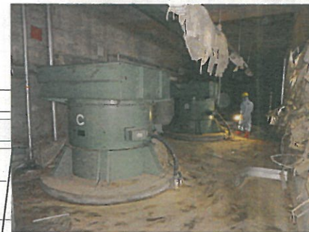
1号機非常用D/G非常用送風機
