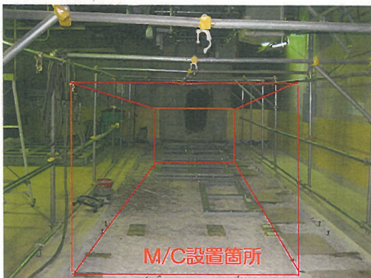
非常用電源盤設置箇所 (M/C室)
