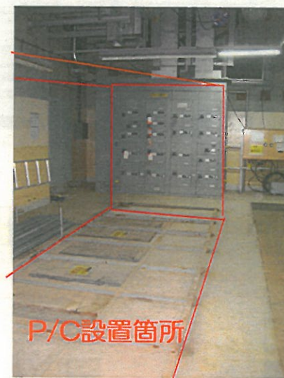
1号機 P/C室 (熱交換器建屋内)
