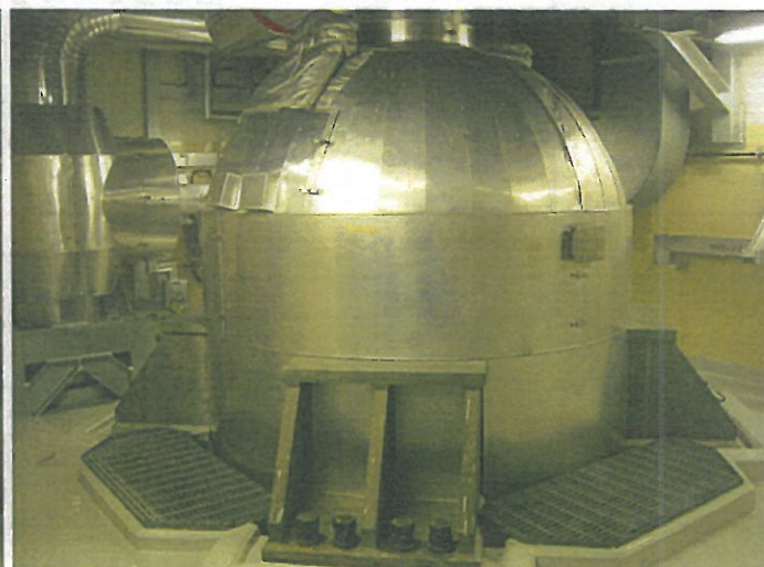
1号機残留熱除去系(RHR)熱交換器
