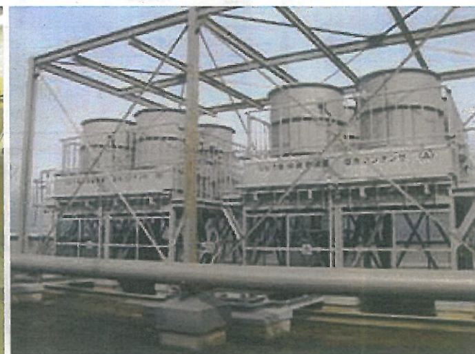
1号機中央制御室空調用コンデンサー
