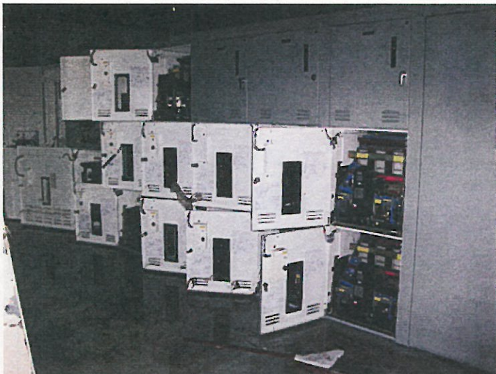
海水熱交換器建屋内 動力電源盤
