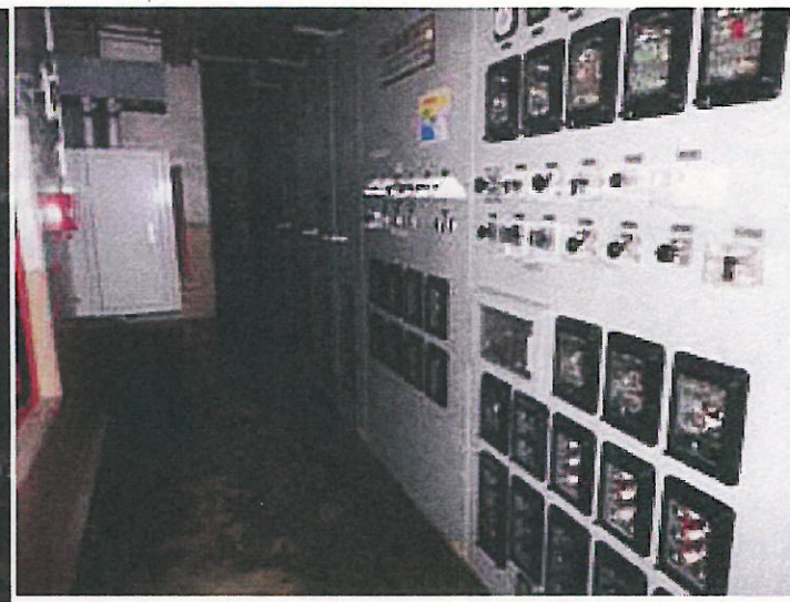
1号機非常用ディーゼル発電機(A)制御盤
