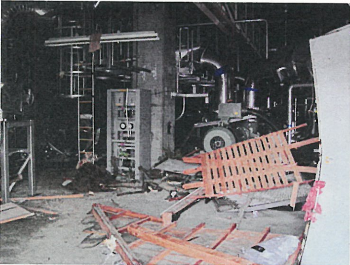
海水熱交換器建屋内
