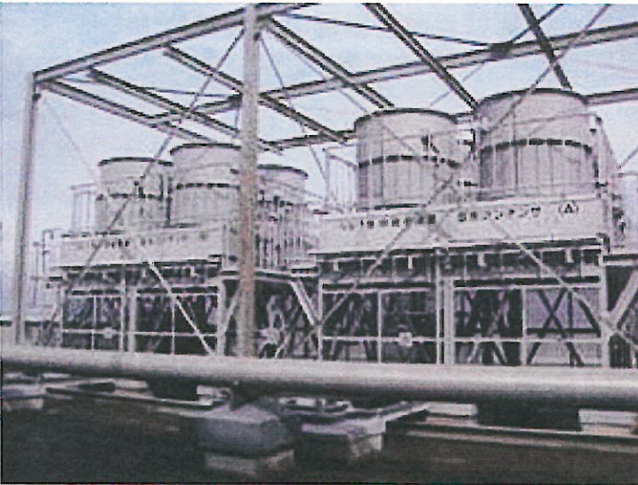
中央制御室空調用コンデンサー
