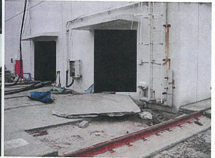
海水熱交換器建屋入口扉
