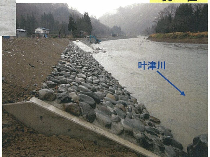
堅盤橋より上流 （只見町大字叶津地内） 自然石護岸工事が完了。 （平成24年11月30日撮影）
