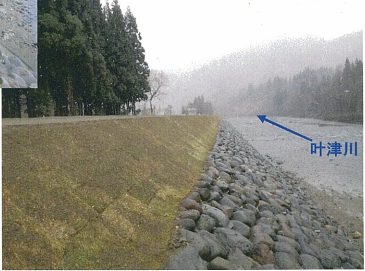
3工区(只見町大字叶津地内) 自然石護岸工事が完了。 (平成24年11月30日撮影)
