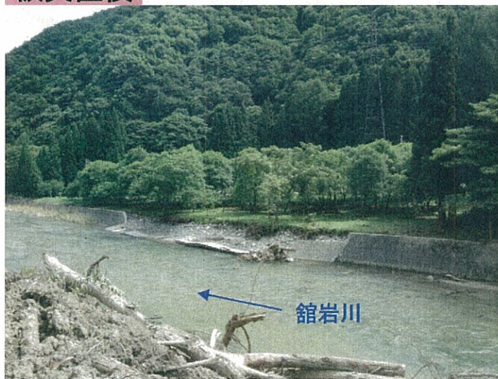
館岩川：南会津町恥風地内（平成23年8月7日撮影）
