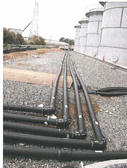
処理水貯槽～バッファタンク (淡水ライン:実施中)
